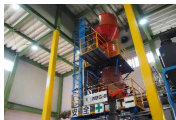
バイオマス発電所
