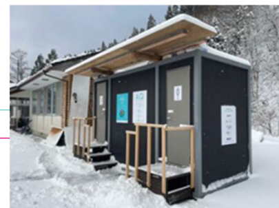
能登町の避難所に設置されたA.Q.トイレ
