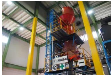
バイオマス発電所
